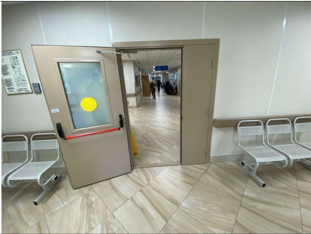
Фото №31 – Пути движения внутри здания (двери). В полотнах установлена яркая маркировка.
